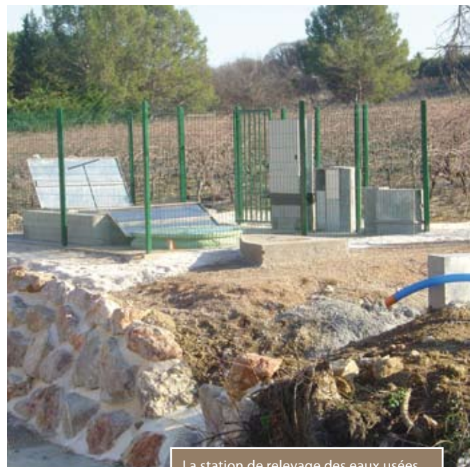
La station de relevage des eaux usées.
