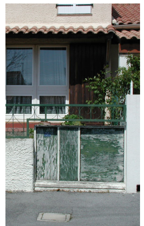
Décalage inesthétique entre hauteur du coffre et mur
