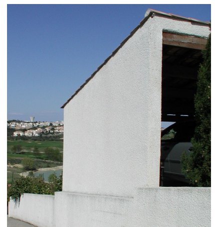
Discontinuité entre une construction annexe en limite séparative et le mur de soutènement
