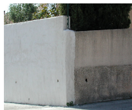
Discontinuité des enduits en couleurs et/ou textures
